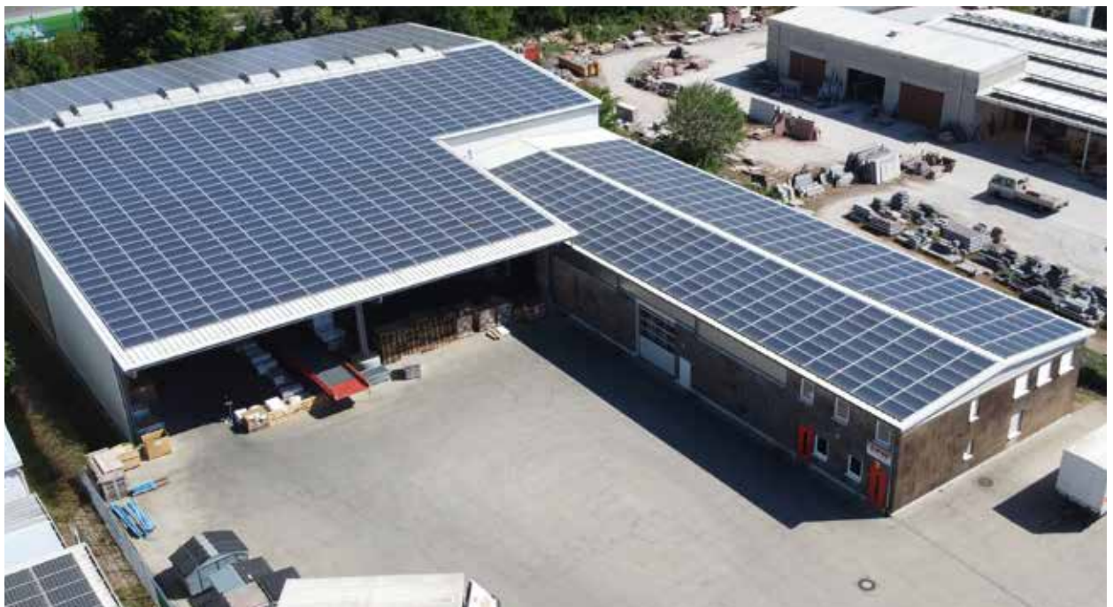
Abbildung 15: Kork-Fassade und PV-Anlage beim Zipse Standort Kenzingen
